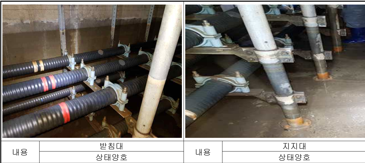
【사진 3.4】 부속 및 부대설비 현황
