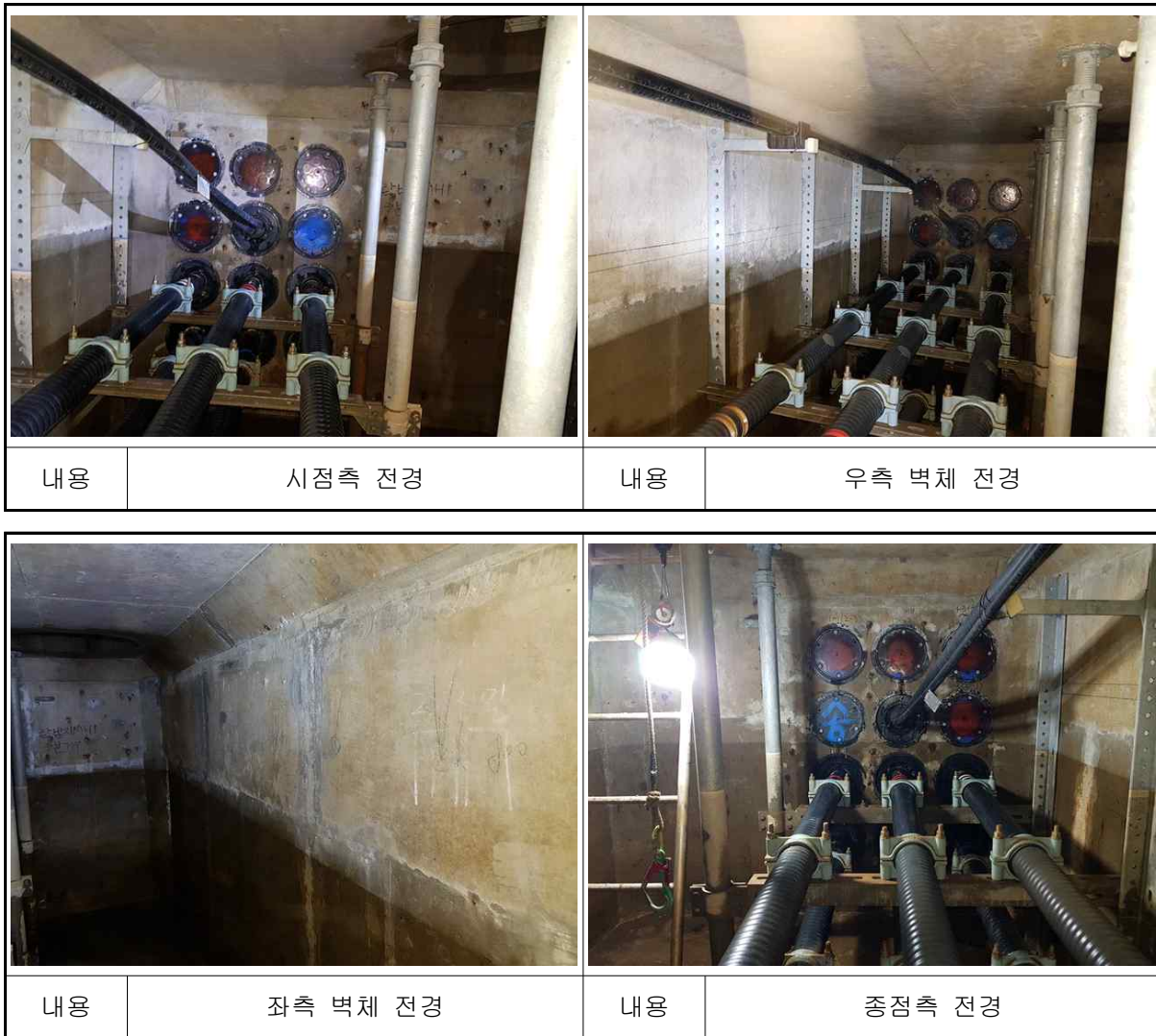
【사진 3.1】 덕소~진건#S/S 전경
