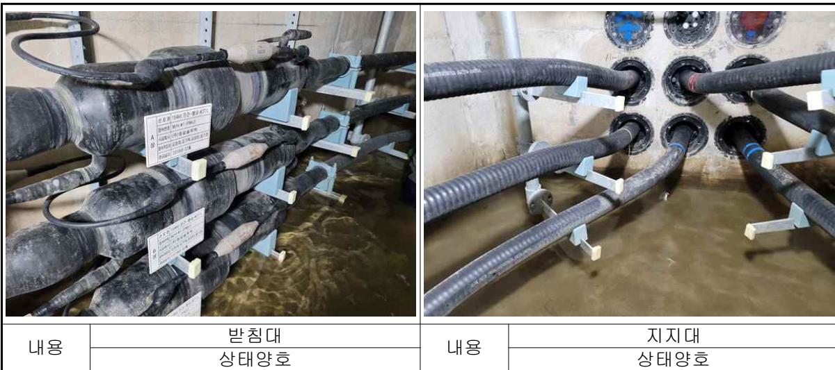
【사진 3.12】 부속 및 부대설비 현황
