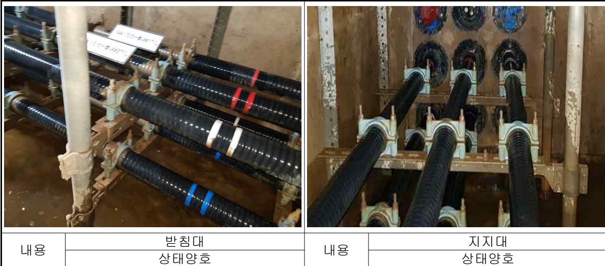
【사진 3.8】 부속 및 부대설비 현황
